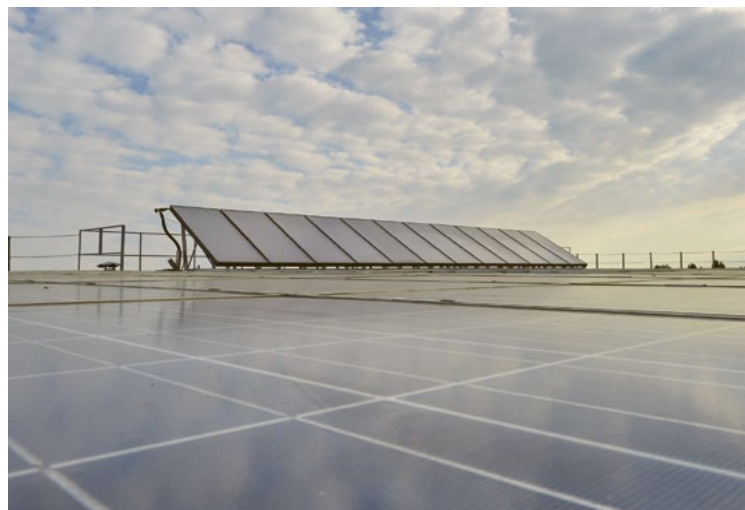
Installation photovoltaïque et thermique de l'école Jean-Louis Marquêze, à Limeil-Brévannes.
