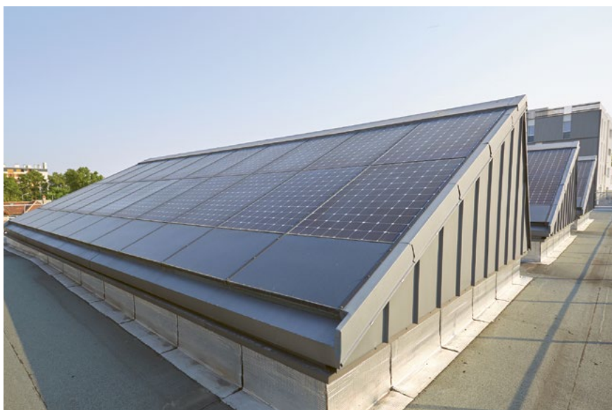
Installation photovoltaïque du groupe scolaire Abdelmalek Sayad à Nanterre.
