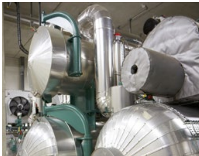
Les pompes à chaleur
